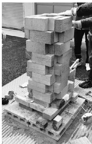
図 5. 完成したたたら炉. 耐火レンガの継ぎ目を覆う形に外側のレンガを配置してある. レンガ自体は針金で外周を巻いて固定した.
