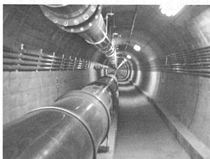
写真3：恒久排水路トンネル設備で処理施設へ導水している（2009年2月、関撮影）。
