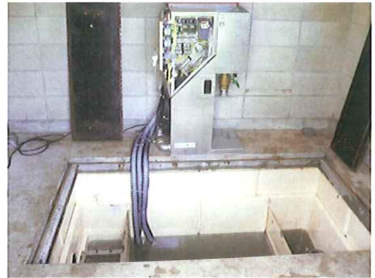
写真55 油分自動回収装置
