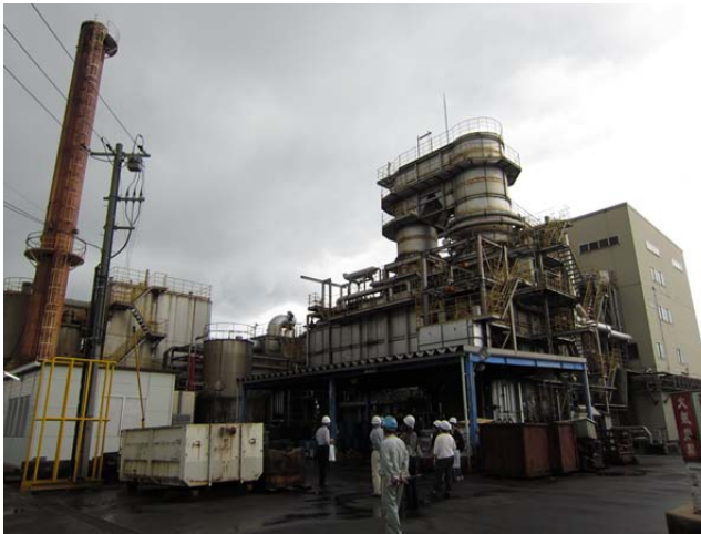
潮見工場焼却炉
