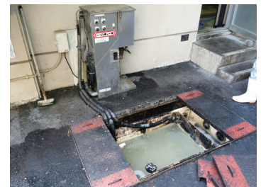
グリストラップの様子 (集約桝のフタを開けたところ)
