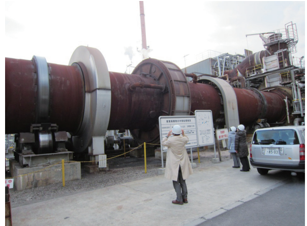
実験廃液、不要薬品等を焼却する大型キルン焼却炉 （住友化学新居浜工場内）。
