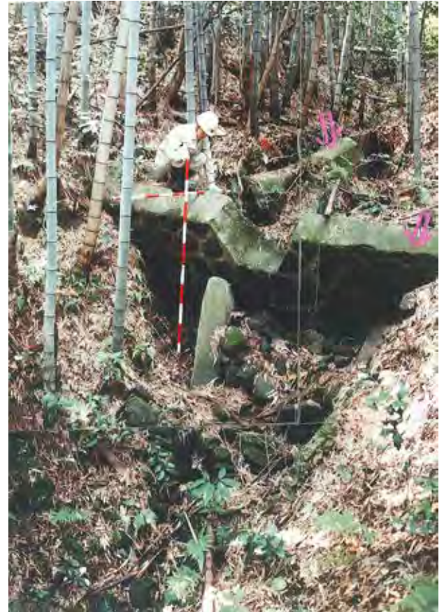
写真 1.2.7 昭和初期に建設された落差工 この地すべりによって破損した。
