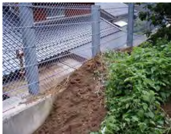
写真1.2.55 崩壊土砂の捕捉状況
