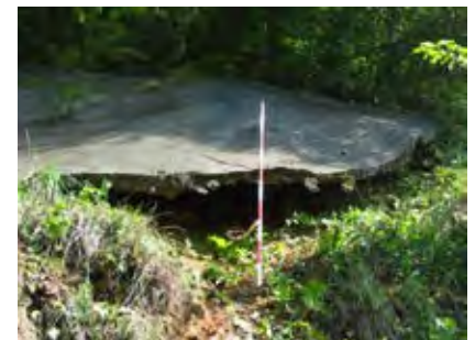
写真1.2.33 端部の空洞化
