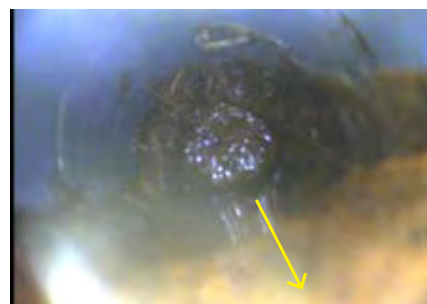
写真 1.2.74 閉塞状況 (木根)
