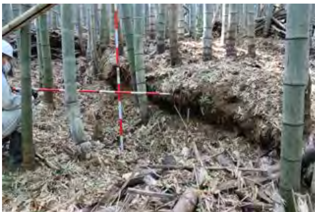
写真 1.2.6 大正時代に発生した地盤の亀裂 その後、豪雨のたびに拡大した。
