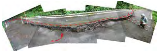
写真1.2.1 主測線地すべり頭部の滑落崖
