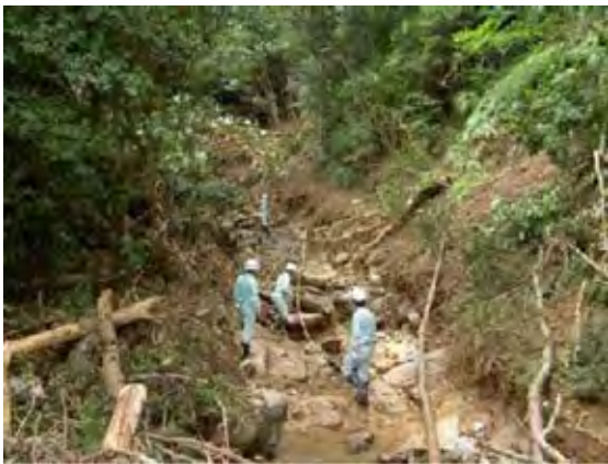
写真1.2.53 トンネル口上の溪床の浸食状況（露岩）
