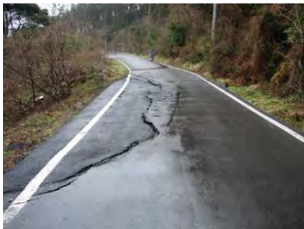
写真1.2.77 観測開始当時の路面亀裂 (2/16)
