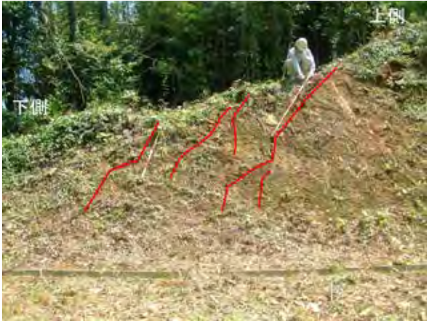
写真1.2.25 最上部の開口亀裂 崖上部の切土のり面に雁行状に発生した亀裂。
