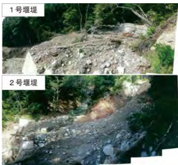
写真2.3.3 既設堰堤の満砂状況
