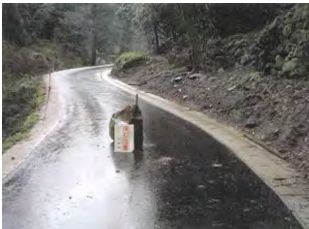
写真 1.2.90 平成 22 年 3 月 28 日に発生した落石 落石の直径は約 0.7 m。
