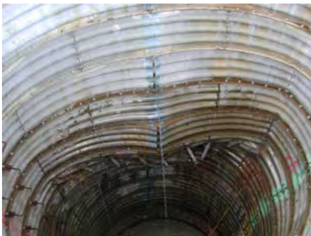
写真1.2.9 地すべりによって変形した集水井 湧水は多い。
