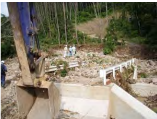
写真1.2.49 大津久にある工事用道路橋の土砂災害状況
