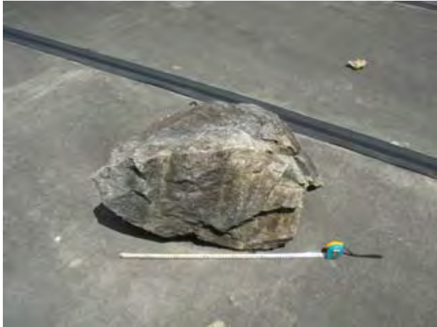
写真1.2.37 スノーシェッド上の落石
