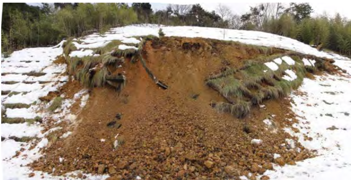
写真1.2.58 発生直後の地すべり末端
