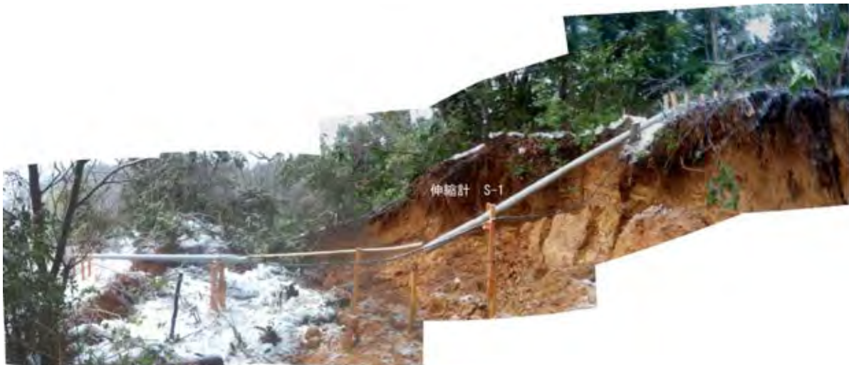
写真1.2.57 頭部の陥没帯
