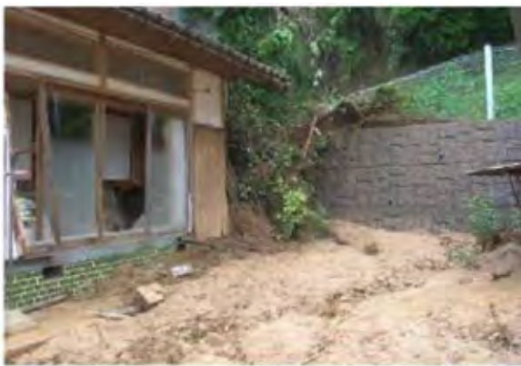
写真2.3.7 太一垣地区の被災状況
