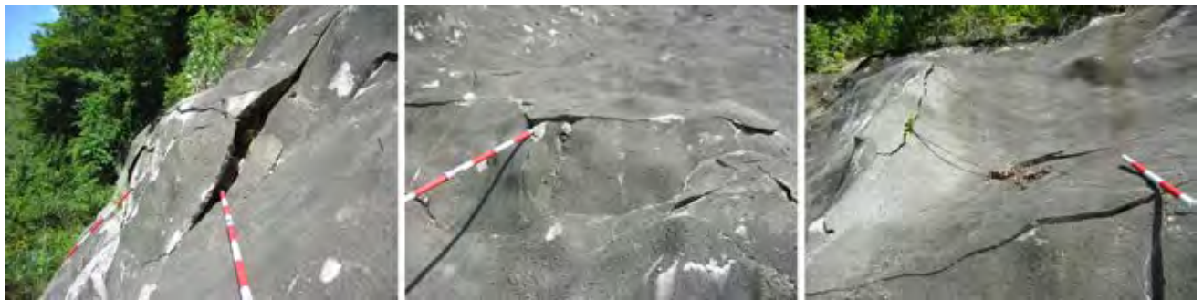
写真1.2.31 のり尻付近の開口亀裂 縦横及び亀甲状の亀裂が混在する。
