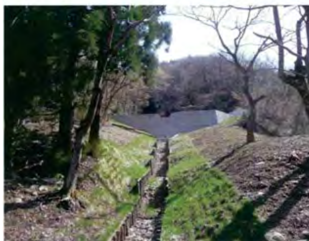
写真2.3.4 下流側の水路工の被災状況 (上:被災後、下:被災前)
