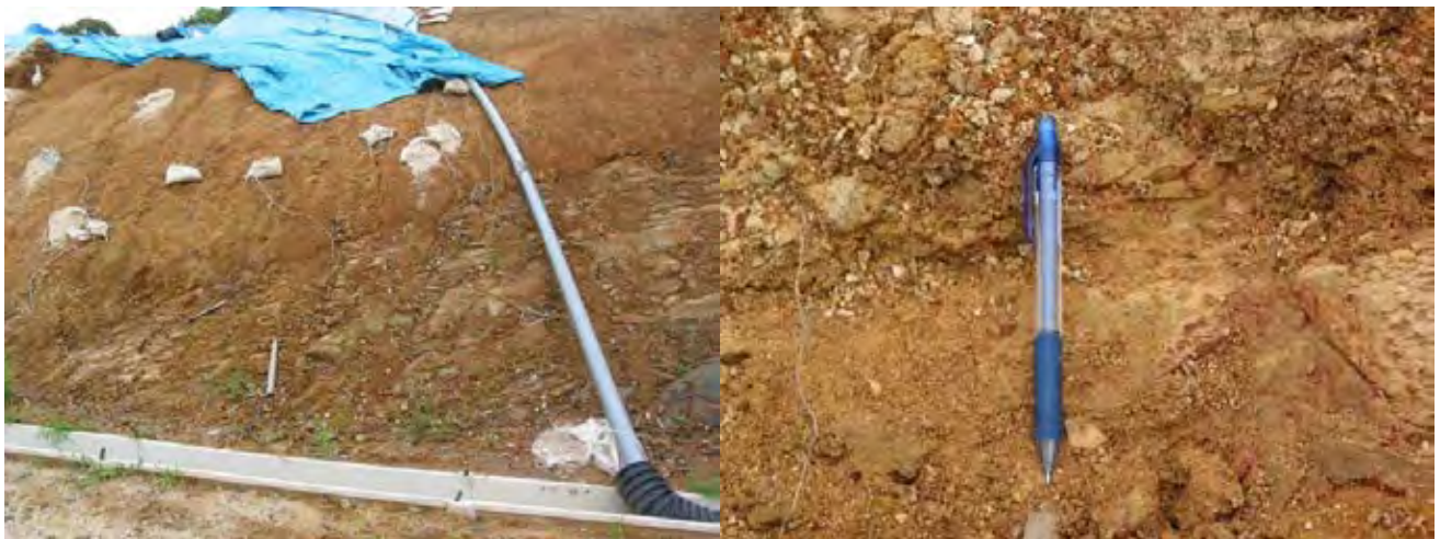
写真1.1.2 地すべりのすべり面の例
