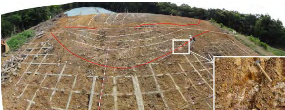
写真1.2.61 崩土除去後の地すべり末端状況 赤線は連続した粘土層。
