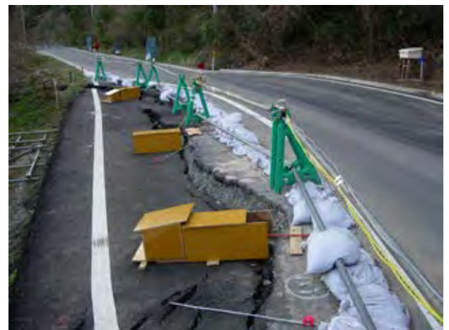
写真1.2.78 観測開始1ヶ月後の路面亀裂 (3/20)
