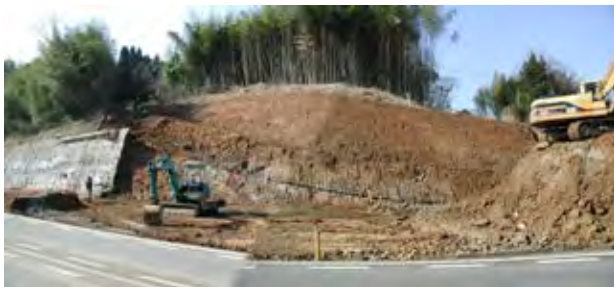
写真1.2.8 広域農道のり面で発生した地すべり
