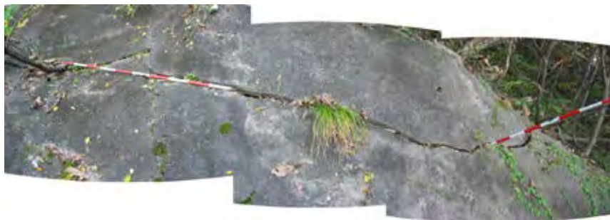
写真1.2.32 のり面上部の開口亀裂 水平方向に10m以上連続する。
