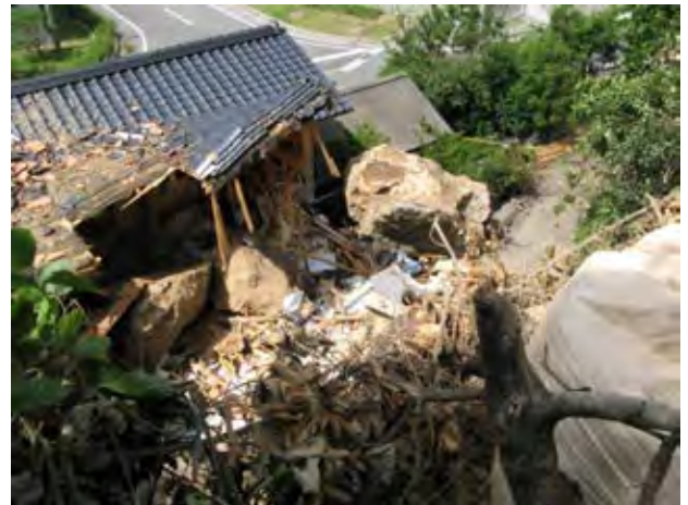
写真 1.1.4 2010年7月の豪雨で発生した松江市鹿島町恵曇の落石災害
