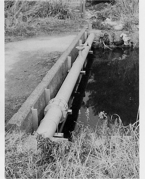
1.4 揖屋干拓地タメ池への送水管
