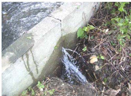
写真-1 目地損傷部からの漏水
